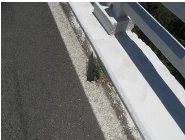
Foto 54: Bordo Leste – Buzinote obstruído.
