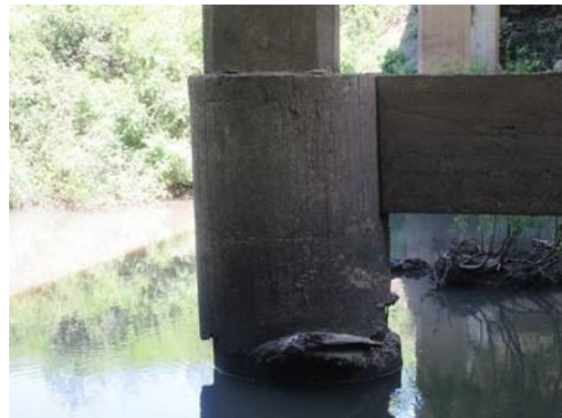
Foto 37: Desalinhamento entre tubulão e pilar.
