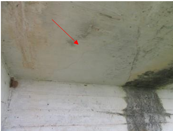
Foto 14: Balanço oeste – Fissura horizontal.
