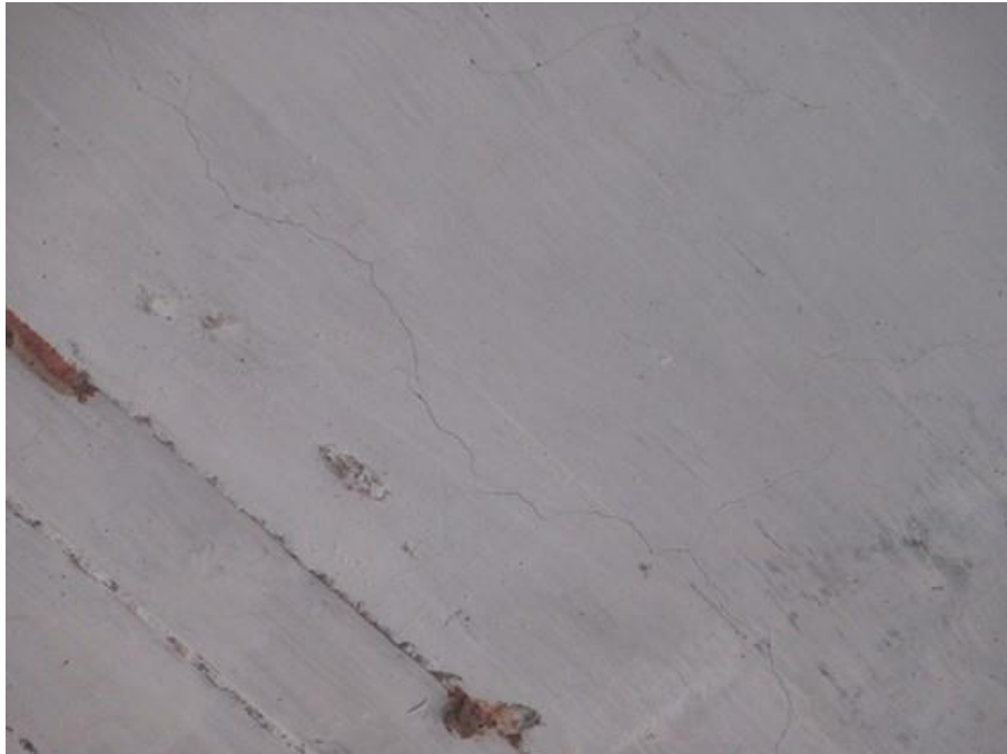
Foto 12 (IMG_1183): Tabuleiro - Fissura.
