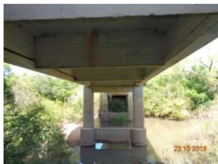
Foto 3. Vista inferior. Nota-se falha construtiva no alinhamento entre pilares e tubulões no apoio AP2
