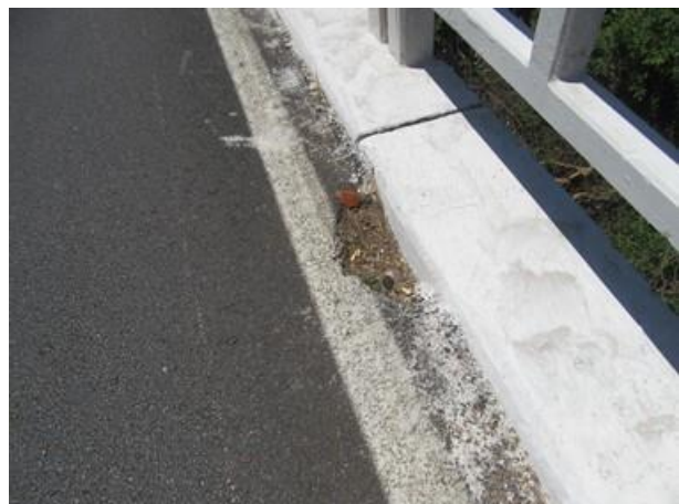
Foto 55: Bordo Oeste – Buzinote obstruído.
