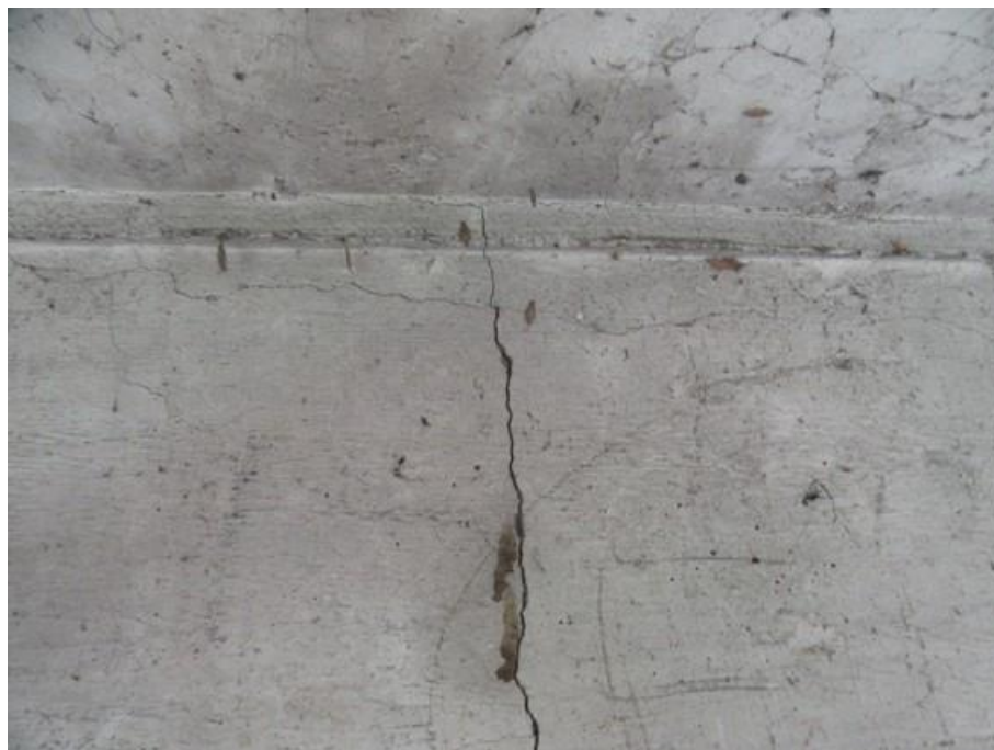
Foto 04 (IMG_1032): Cortina 2 – Balanço Norte - Fissuras.
