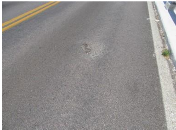
Foto 47: Pista Oeste - Panela.
