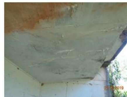
Foto 4. Laje em balanço apresentando fissuras com elforescência.
