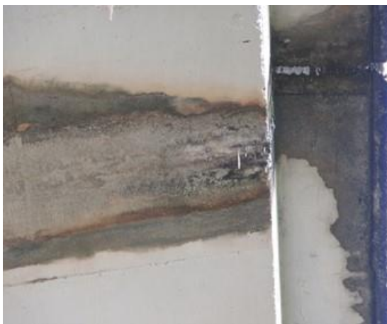
Foto 10: Balanço oeste – Eflorescência e formação de estalactites.
