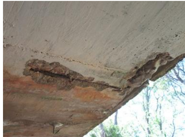
Foto 9: Balanço – Armadura exposta.
