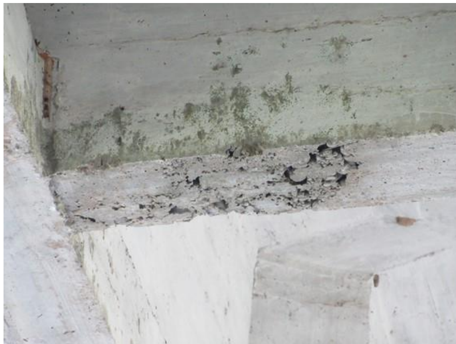
Foto 18 (IMG_1359): Transversina 3 – Concreto Segregado.
