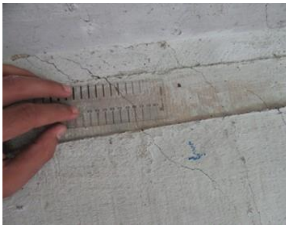
Foto 19: Viga longarina 2 – Face oeste - Fissuras.
