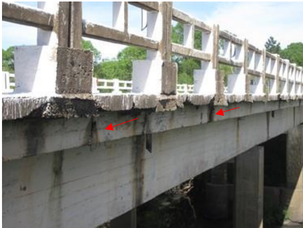
Foto 8: Balanço – Armadura exposta.
