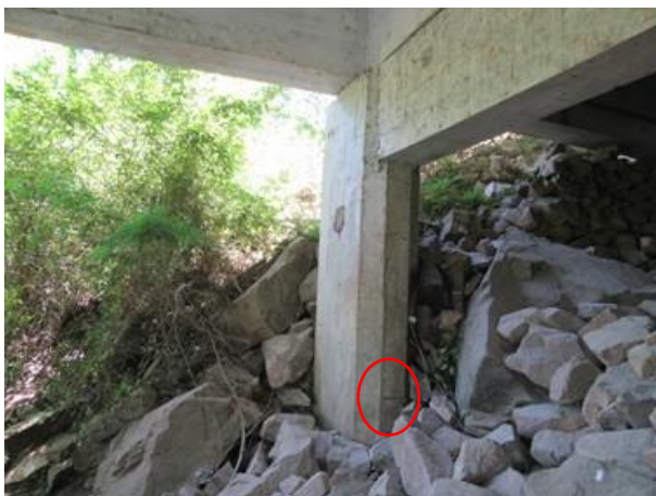
Foto 31: P1 – Oeste - Armadura exposta e redução de cobertura.
