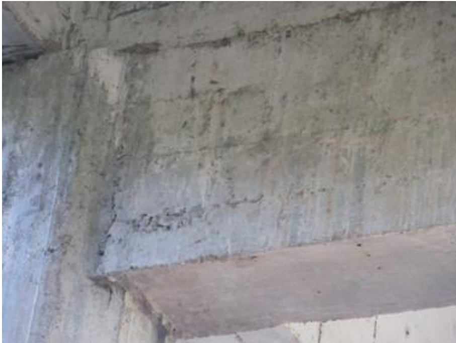
Foto 33: Travessa do apoio 3 – Concreto segregado.
