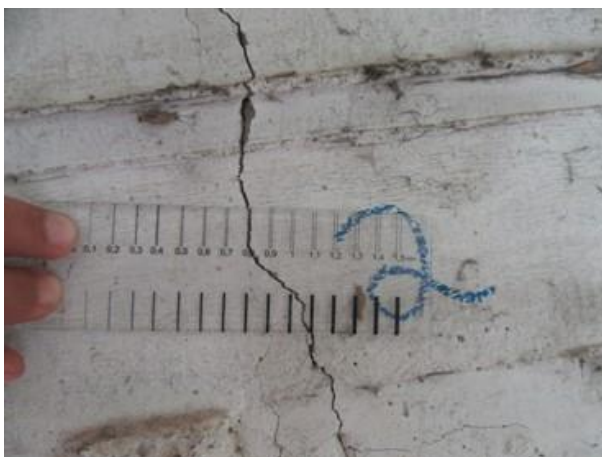
Foto 27: Cortina – Encontro 2 – Fissura vertical (Abertura igual a 0,8 mm).
