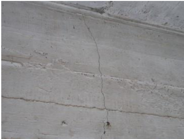
Foto 25: Viga transversina 10 – Face norte – Fissura vertical.
