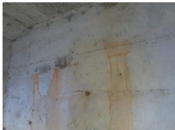
Foto 28: Cortina - Encontro 1 - Fissuras verticais.
