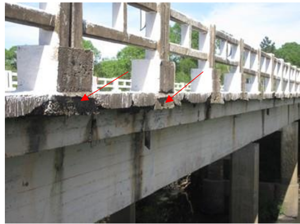
Foto 57: Pingadeiras com interrupção devido a instalação inadequada dos guarda corpos.
