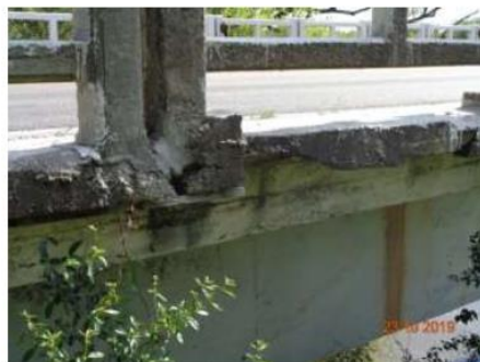
Foto 5. Concreto disgregado na laje em balanço.
