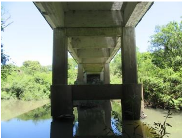
Foto 36: Apoio 2 - Face norte - Desalinhamento.
