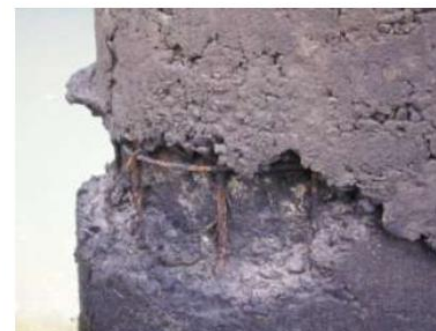
Foto 8. Concreto segregado com armadura exposta e corroida, bem como estribo rompido no tubulão.
