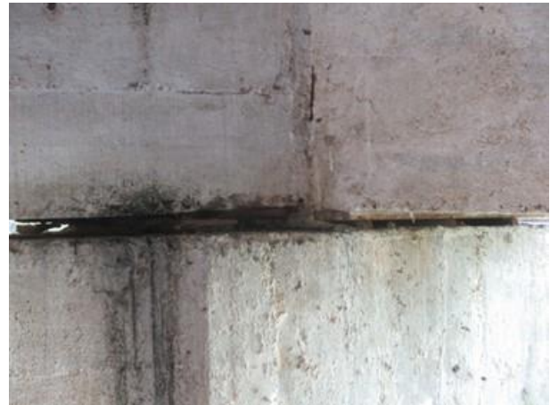
Foto 30: Aparelho de apoio do tipo Freyssinet – Acúmulo de detritos.
