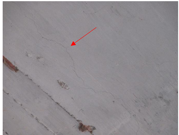
Foto 15: Tabuleiro entre VT8 e VT9 - Fissura horizontal.
