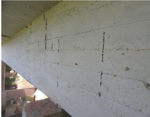
Foto 21: Viga longarina 2 - Armadura exposta e ausência de cobrimento.
