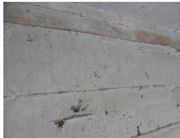
Foto 20: Viga longarina 2 – Face oeste - Fissuras.
