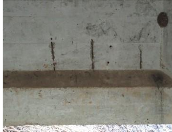
Foto 22: Viga longarina 1 - Armadura exposta e ausência de cobrimento.
