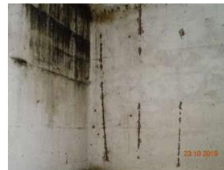
Foto 6. Concreto disgregado com armadura exposta e corroida na viga longitudinal.
