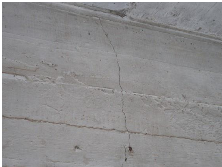
Foto 06 (IMG_1071): Viga transversina 10 – Face Norte.
