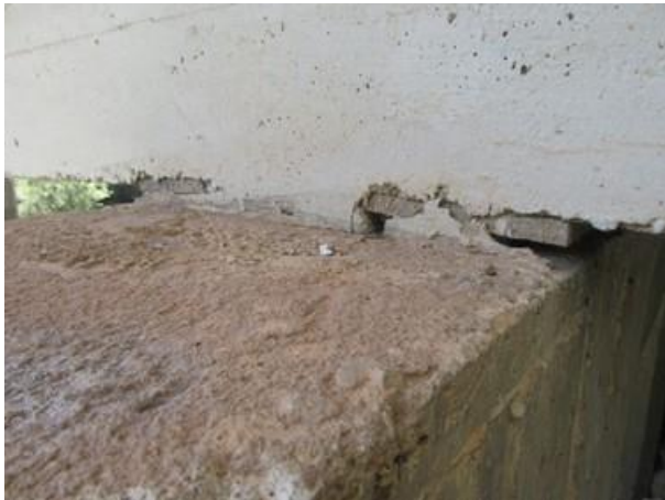
Foto 29: Articulação Freyssinet - Apoio 4 - Oeste - Resíduo de forma.
