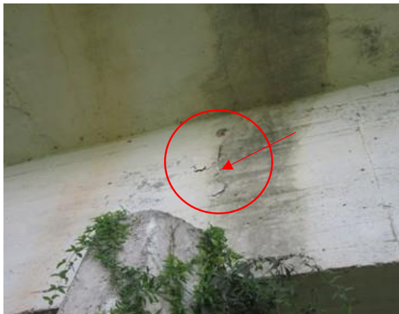
Foto 17: Viga longarina oeste – Concreto desagregado com armadura exposta – Cobrimento insuficiente.
