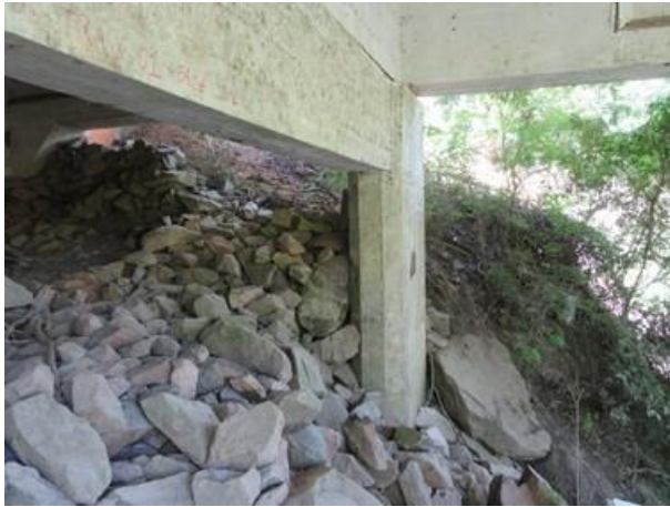
Foto 38: Talude lateral oeste – encontro sul.
