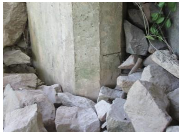
Foto 32: P1 – Oeste - Armadura exposta e redução de cobertura.
