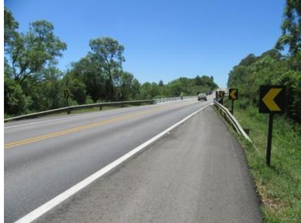
Foto 53: Defensas metálicas - Aproximação sul.
